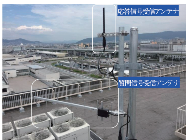
図13 質問信号受信アンテナと応答信号受信アンテナ設置例
